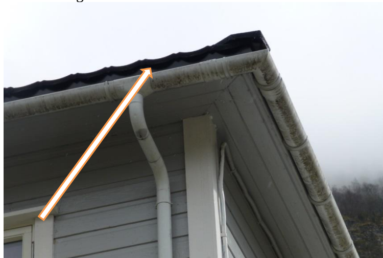
Figur 8-4 Tildekkete hulrom under takplatene på Kyrkjeteigen 2. Pilen peker på tildekking av åpning under takplatene. Merk også at raftekassen er horisontal og tett. Foto SP Fire Research.
