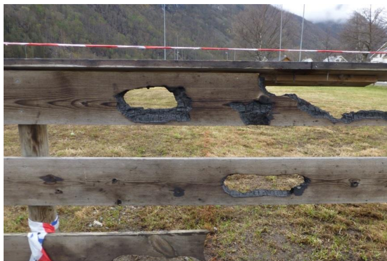
Figur 8-1 Skader på gjerdet i østenden av idrettsbanen. Hullene i gjerdet er sannsynligvis dannet av flyvebranner som har festet seg på gjerdet. Bildet er tatt fra vestsiden av gjerdet. Foto: SP Fire Research.
