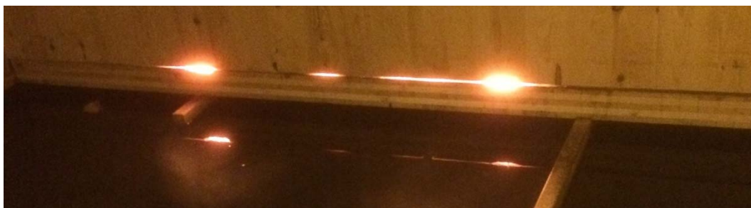
Figur 5.1 Figuren viser at det brant gjennom i overgangen mellom gulv og vegg på badet der det ikke var støpt gulv.
