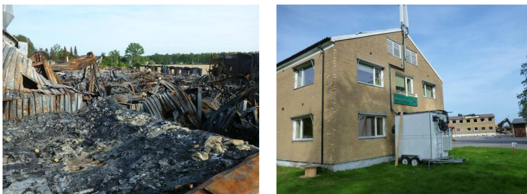
Figur 2-3 Restene av BASA-Huset. Bildet til venstre er tatt mot nord fra baksiden av bygningen, og portene synes i bakkant av bildet. Bildet til høyre viser kontorbygget, og i bakgrunnen ses en gravemaskin i ferd med å rydde branntomten (Foto: SP Fire Research under befaringsen 2015-09-10).
